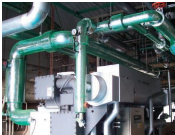
蒸気二重効用吸収式冷凍機
